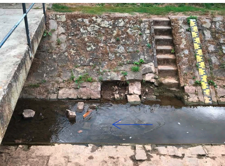
Schadhafte Uferböschung im Bereich des Pegels Gaugrehweiler vor der Sanierung
